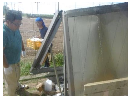
崩壊した物置を撤去中
