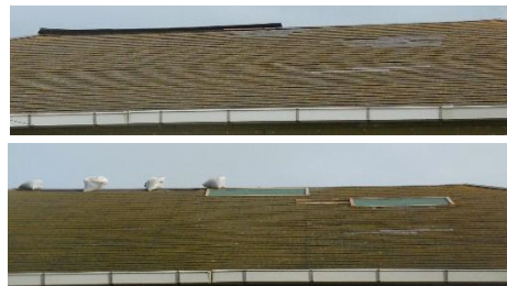
三崎の屋根 補修前(上)と補修後
